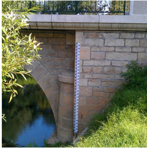
Figure 6.1 : Echelle verticale mesure le niveau de barrage.
