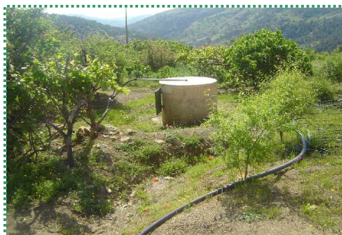
1. Puit pour irrigation (Sidi Slimane)
