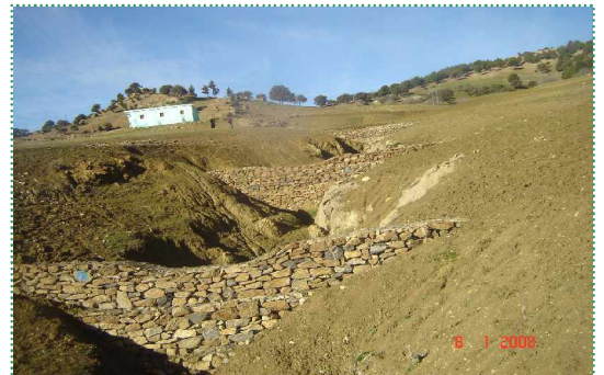
Photo: 6.1.1. Correction torrentielle en pente moyenne
