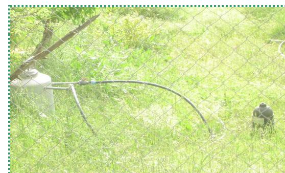
4. Réseau pour G. à goutte (Boucaid)
