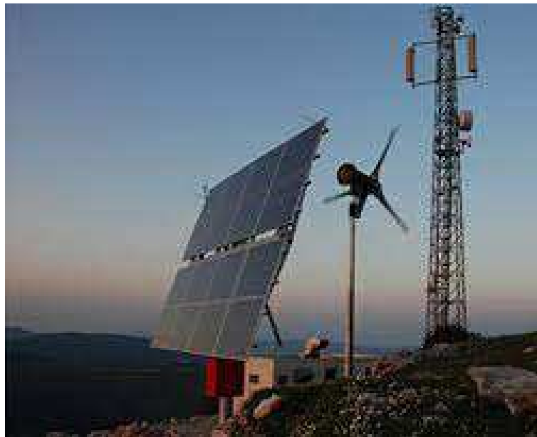
Figure. II.1 : Installation d'une BTS alimentée en hybride (PV et Oléen) [2]
