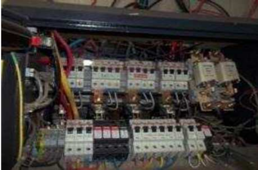
Figure II.2. Équipement de redressement sur le site de la BTS [1].
