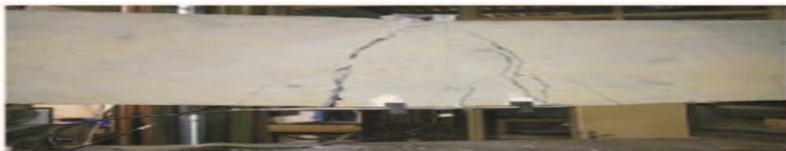
Figure 2.34. Rupture de la poutre fortement armée provient de la rupture d'enrobage vers la mi- portée de poutre. [BENN 13]
