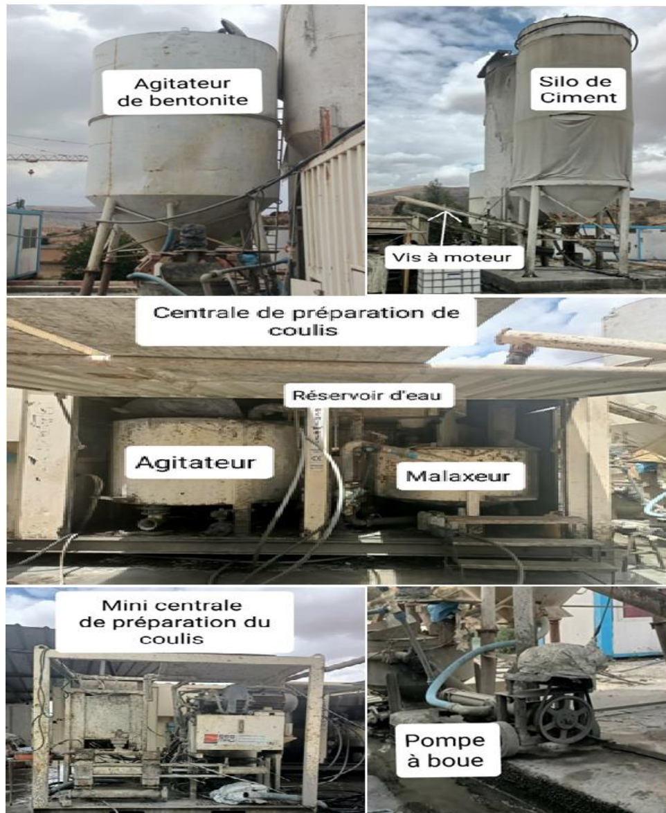
Figure V-16: Ensemble de la centrale. (ANBT ; Geomag, 2022)
