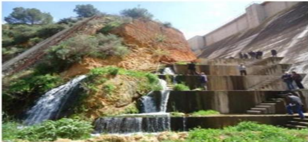
Zone humide et fuite au pied aval rive droite
