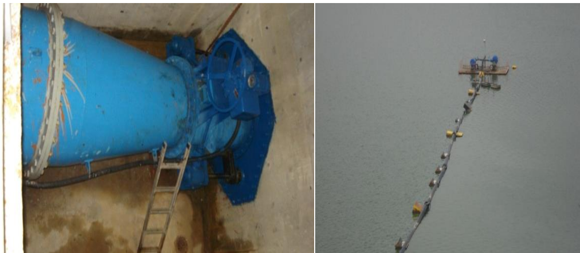
Conduite pour l'irrigation
