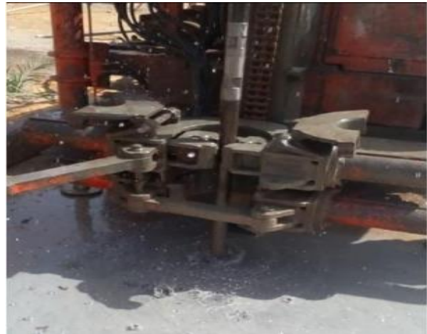
Abondante circulation d'eau lors du reforage d'un trou injecté
