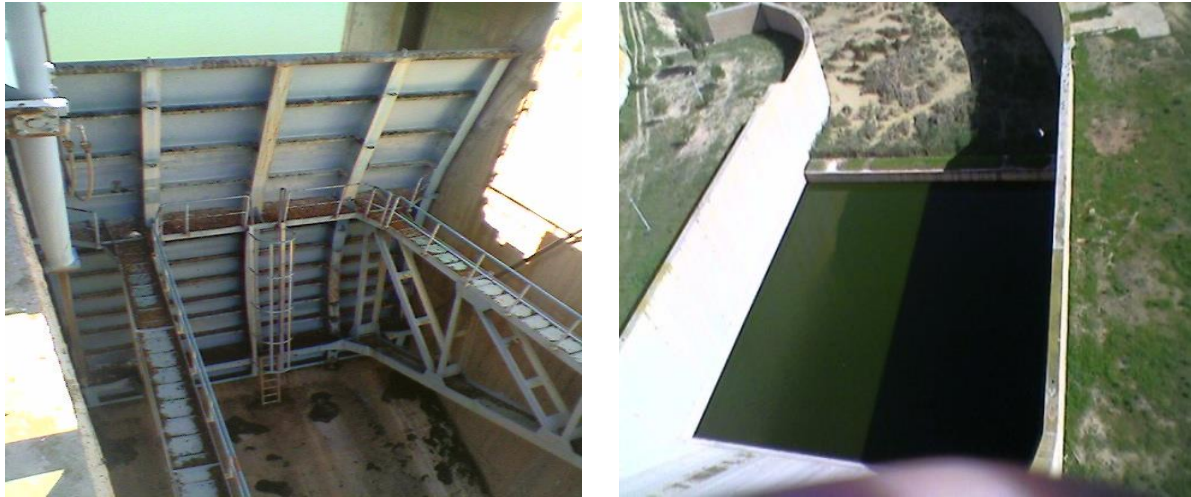
Une des vannes Batardeau
