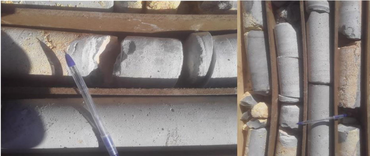
Figure V-31: Remplissage des vides par les coulis en gris dans les calcaires sableux du Tortonien.
