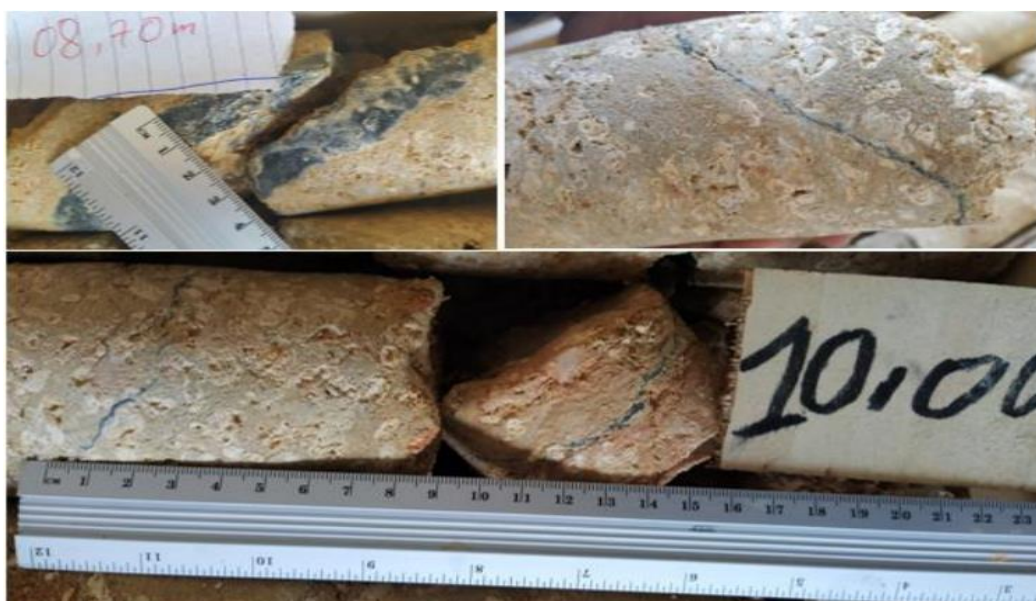
Figure V-66: Les traces de coulis d'injection dans les fissures.
