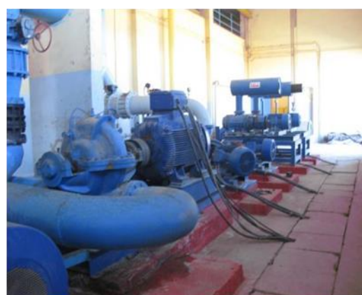
Station de pompage d'eau traitée
