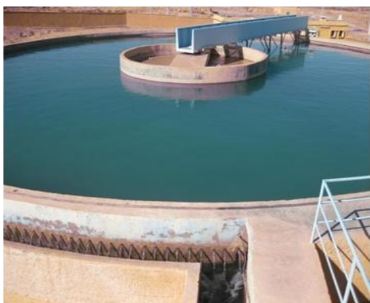
Réservoir de décanteur
